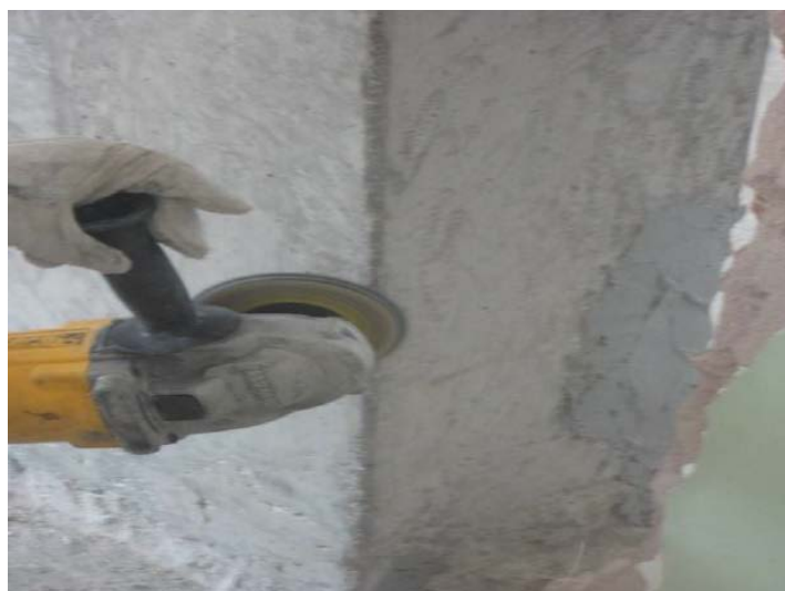
Figura 15 – Arredondamento das quinas do P4.
