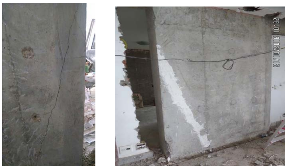
Figura 14.a e Figura 14.b – Trinca existente no P4 e P7.
