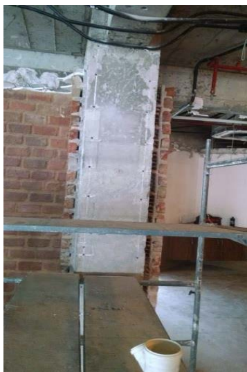
Figura 8 – Superfície do pilar apicoada e furada, aguardando armação de reforço.
