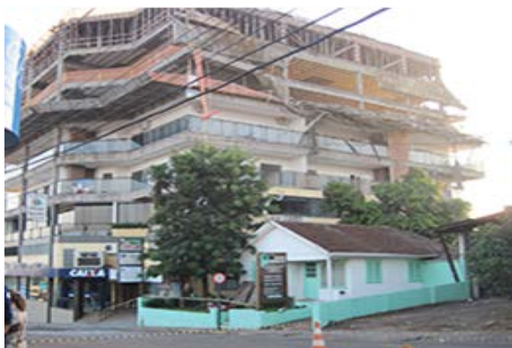
Figura 1: Queda de marquise - Edifício residencial em Teutônia - RS.
