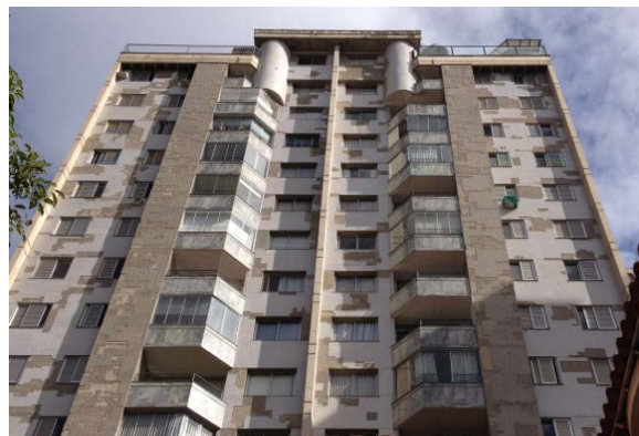
Figura 2: Patologias de fachada - Edifício residencial em Belo Horizonte - MG.
