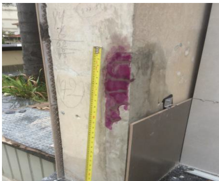
Figura 01: Aplicação de fenolftaleína na área recuperada Fonte: Elaborada pelo autor, 2017
