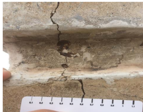
Figura 02: Corrosão da armadura por falta de cobertura, gerando fissura. Fonte: Elaborada pelo autor, 2017
