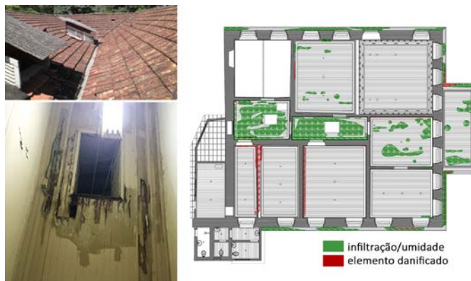
Figura 5. A - Fotografia telhado; B – Fotografia forro interno C - Mapa de danos do forro.
