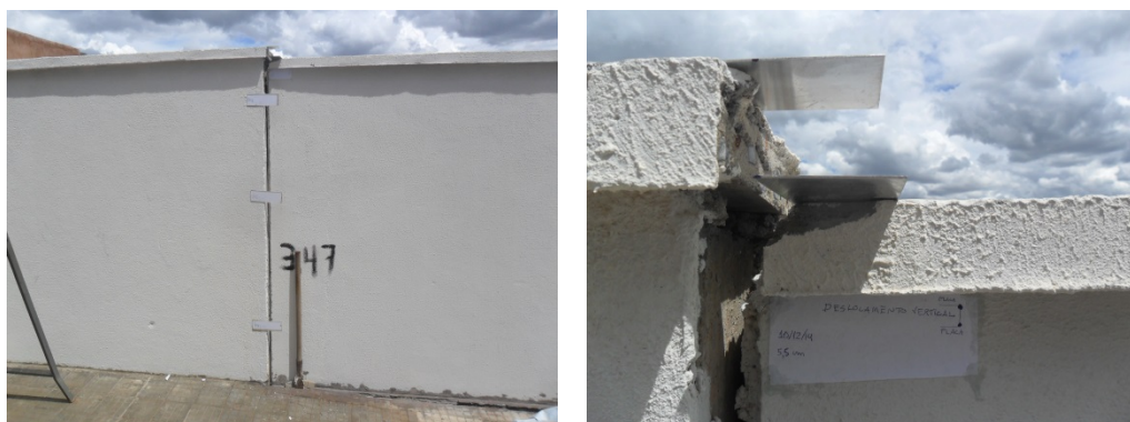
Figura 2: Trinca e desnível do muro em relação à vertical – Fonte: os autores
