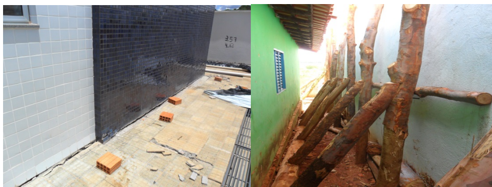
Figura 1: Trinca entre o piso e a construção e escoramento do arrimo – Fonte: os autores
