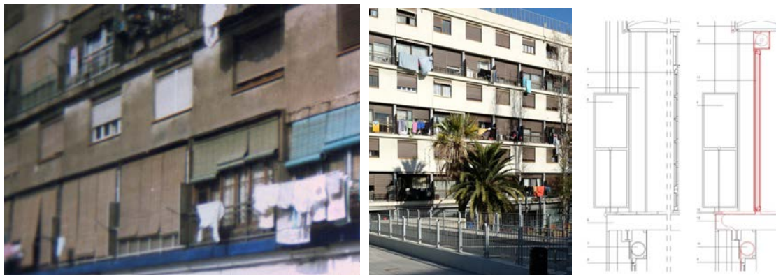
Fig. 8.: Casa Bloc. Antes y después del cambio de las carpinterías de las terrazas y de las persianas
