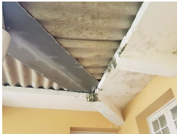
FIGURA 5: Avanços de lajes apresentam manchas e bolor. FONTE: Autores.
