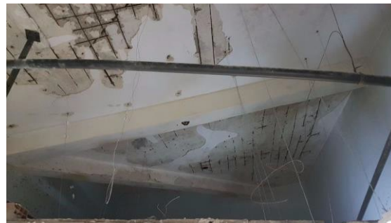
FIGURA 4: Vista das lajes com degradação dos consultórios. FONTE: Autores.
