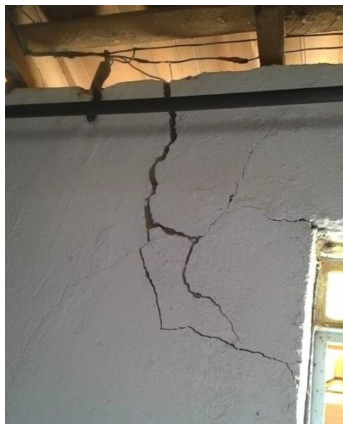
Figura 2: Trincas na alvenaria.
