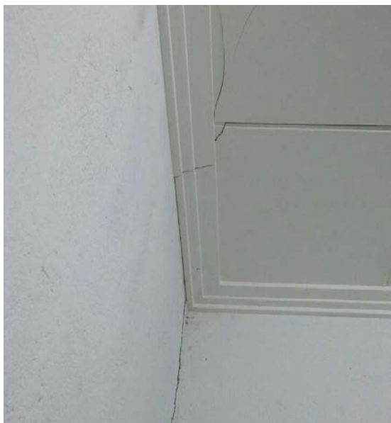
Figura 1: Fissura no forro de gesso.
