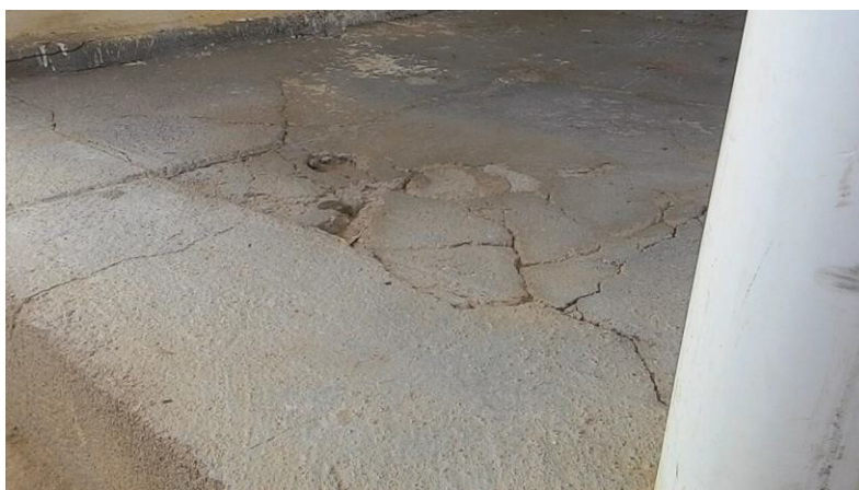
Figura 3 – Piso Fissurado. (Fonte: Própria 2017).
