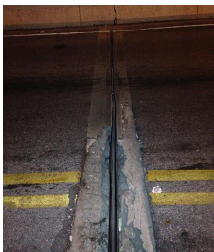
Figura 3: Junta degradada (Fonte: próprio autor)
