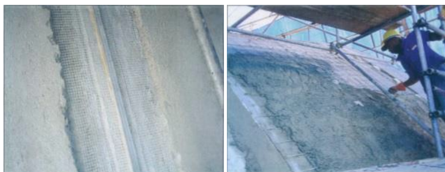
Figura 14: Tela de fibra de vidro aplicada sobre o perfil de alumínio da junta de dilatação para evitar a corrosão galvânica. Figura 15: Aplicação da camada de microconcreto, utilizando o microcimento Duracem AD 300 Holcim, para reconstituição da casca. Fonte: UNESCO, 2016, p. 1963-1968.
