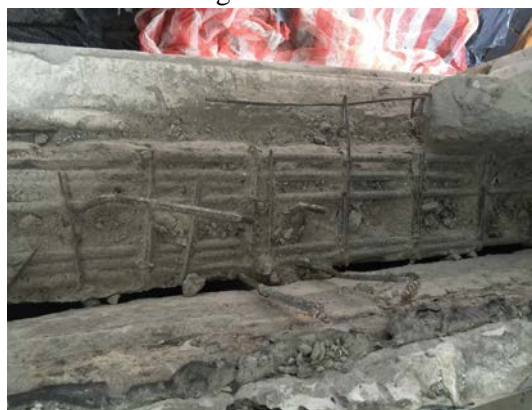
Figura 5: Armadura da viga V1 deteriorada.
