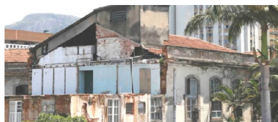
Figura 11: Partes em ruínas de prédios.
