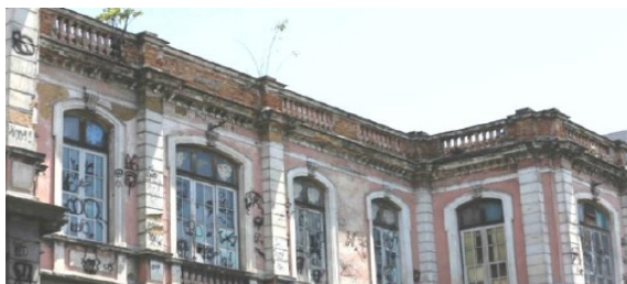
Figura 10: Esquadrias e vidros danificados.
