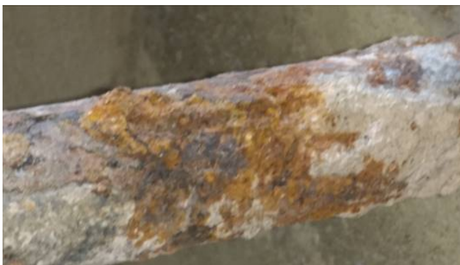
Figura 3: Aspectos externos da mesma tubulação caracterizando degradação avançada do material. (Fonte: Acervo dos autores)
