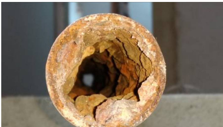
Figura 2: Detalhe da redução da seção útil da canalização em decorrência da corrosão do material e do depósito de e/ou cristalização de elementos presentes na água. (Fonte: Acervo dos autores)
