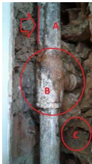
Figura 4: Corrosão por PITE. É uma forma de corrosão extremamente localizada que leva à criação de pequenos furos no metal, orifícios que adentram formando um pequeno “poço”. Exemplos de patologias que produzem ambientes insalubres: a) Vazamento decorrente de PITE; b) Vazamento em conexões; e c) Saturação das alvenarias.
