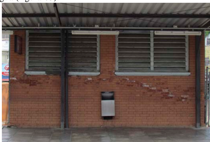
Figura 03: manchas presentes na fachada da latrina, causadas pela umidade vinda do interior da edificação. Notar ainda a presença de eflorescências. Fotografia de Gustavo R. Secco.
