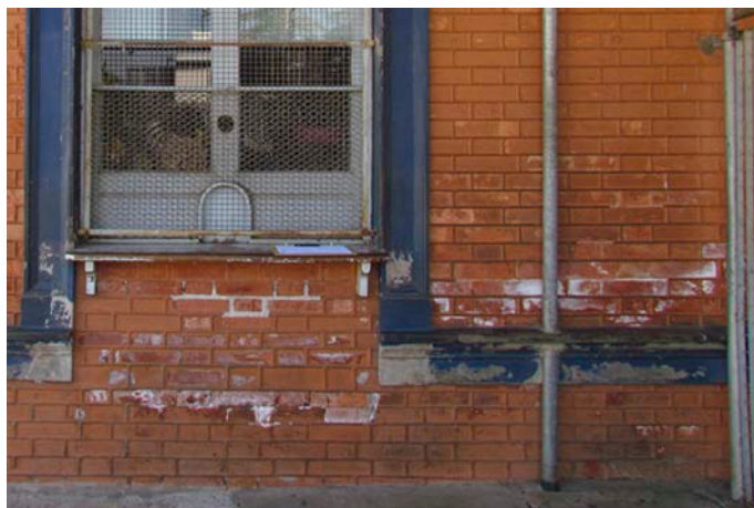
Figura 04: eflorescências presentes abaixo do guichê de bilheteria. Fotografia de Gustavo R. Secco.
