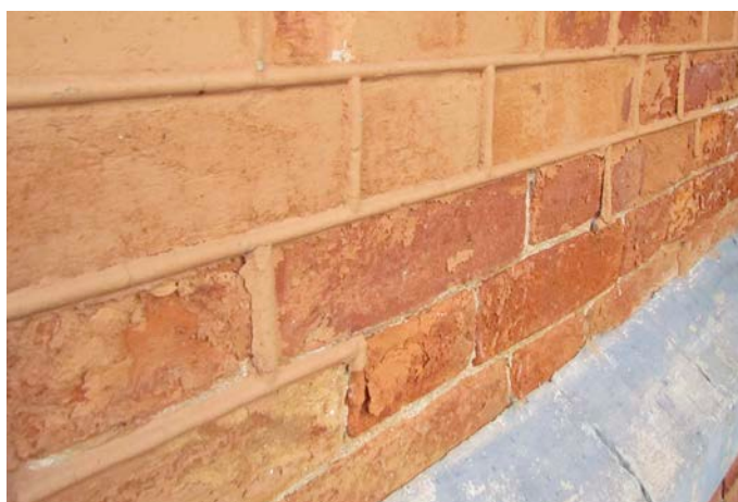
Figura 02: desagregação dos tijolos, sendo possível observar também o desprendimento da película de tinta. Fotografia de Gustavo R. Secco.
