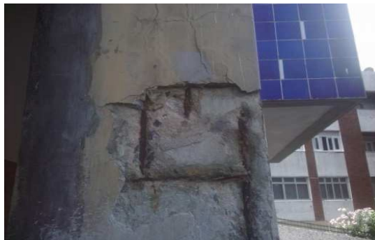
Figura 4: - Detalhe de oxidação em pilar com baixa espessura de cobrimento. (Autores (2017))
