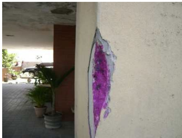
Figura 6: Detalhe de trecho de pilar do térreo ensaiado para avaliação da profundidade de carbonatação (ensaio efetuado com aspersão de fenolftaleína – contraste em cor rosa para os trechos não carbonatados). (Autores (2017))
