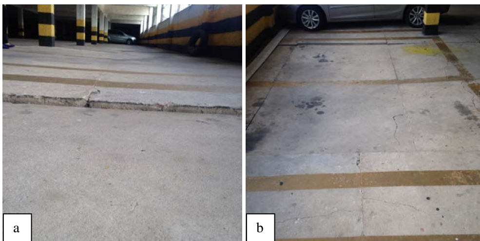
Figura 6: Área 1 com pontos de elevação (a) e rebaixamento (b) de placas no subsolo -2
