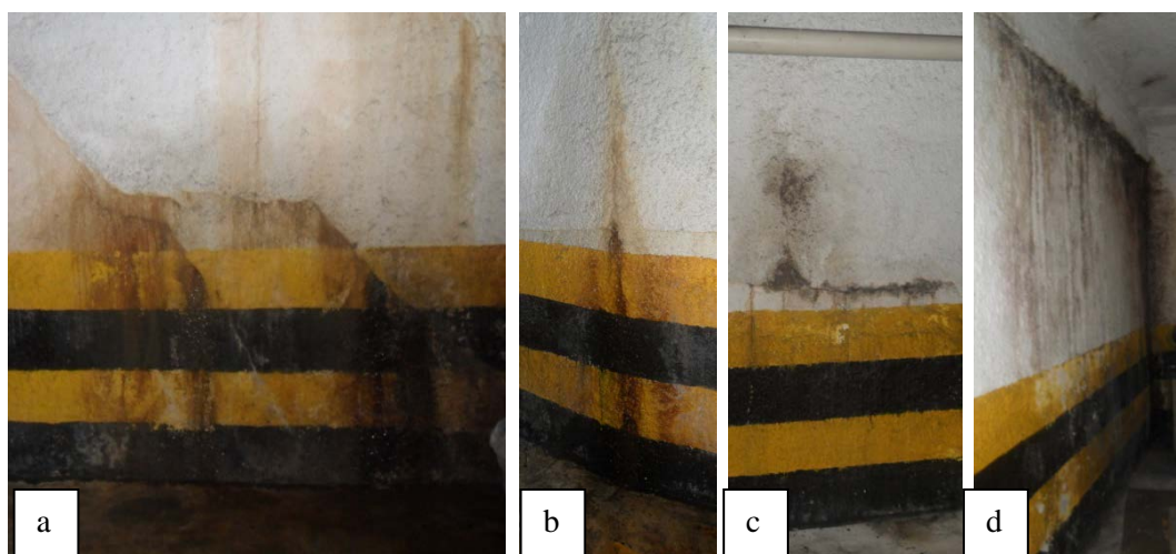
Figura 2: Área com pontos de infiltração no subsolo -1
