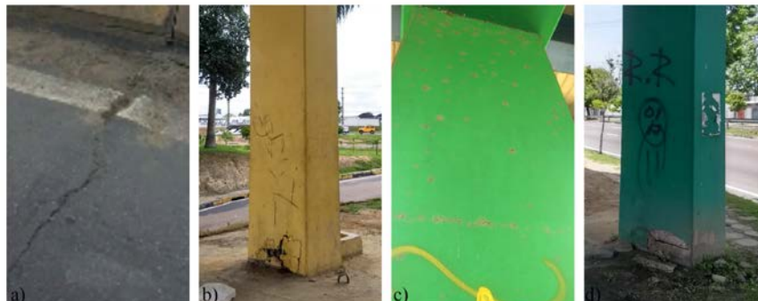
Figura 2: a) Junta de dilatação obstruída no Viaduto Governador Plínio Ramos Coelho; b) Pilar danificado no Viaduto Governador Plínio Ramos Coelho; c) Manchas no pilar do Viaduto Ayrton Senna; e d) Pilar danificado no Viaduto Ayrton Senna. Fonte: Pesquisas de campo.
