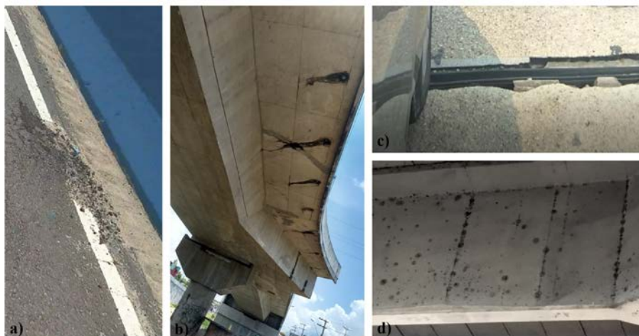
Figura 1: a) Drenagem obstruída no Complexo Viário Av. Rodrigo Otávio; b) problemas de drenagem identificados no Complexo Viário Gilberto Mestrinho; c) junta de dilatação danificada no viaduto Viaduto Miguel Arraes; e d) manchas encontradas na viga do Complexo Viário Gilberto Mestrinho. Fonte: Pesquisas de campo.
