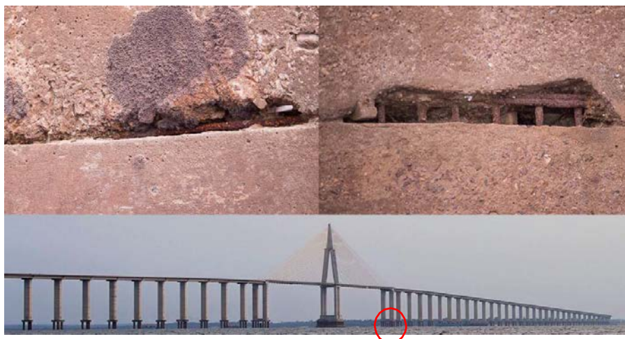
Figura 9: Brecha e formação de estrutura cristalina (à esquerda) e brecha no concreto com corrosão de armaduras (à direita) no bloco de fundação do apoio 39. Fonte: Acervo próprio.
