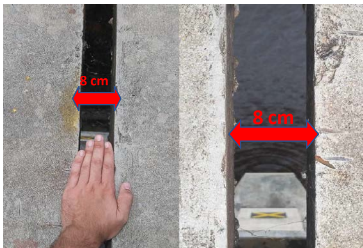
Figura 3: Vão excessivo entre lajes da passarela. Fonte: Acervo próprio.
