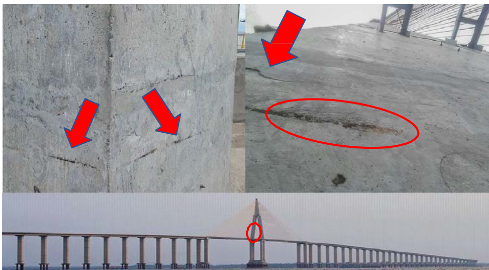
Figura 4: Sinais de corrosão de armaduras em um dos mastros centrais. Fonte: Acervo próprio.
