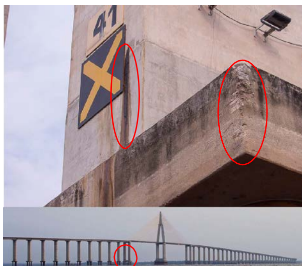
Figura 10: Manchas de umidade e sinal de choque mecânico na infra e mesoestrutura do apoio 41. Fonte: Acervo próprio.
