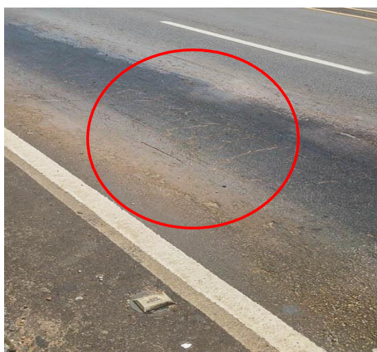
Figura 1: Trincas reticuladas no pavimento. Fonte: Acervo próprio.
