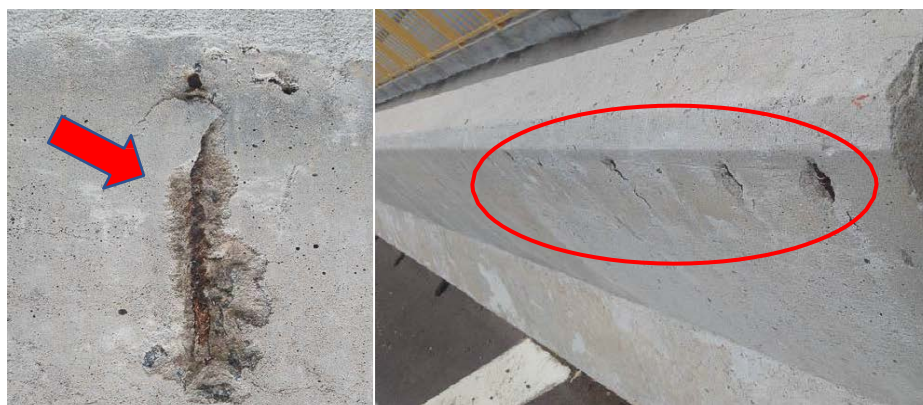
Figura 2: Corrosão das armaduras dos guarda-rodas. Fonte: Acervo próprio.
