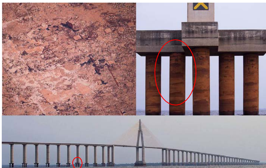
Figura 8: Ninho de concretagem (à esquerda) e desprumo de estaca (à direita) do bloco de fundação do apoio 45. Fonte: Acervo próprio.
