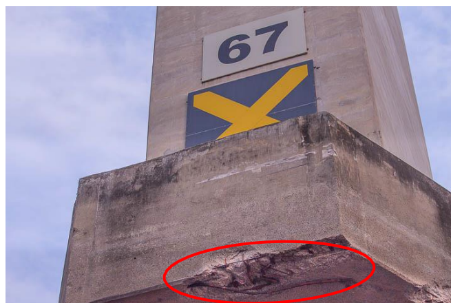
Figura 7: Exposição de armaduras da parte inferior do bloco de fundação do apoio 67. Fonte: Acervo próprio.
