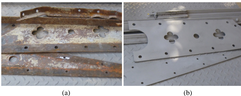
Figura 5: Peças deterioradas (a) e aspecto renovado (b). Fonte: Acervo próprio.
