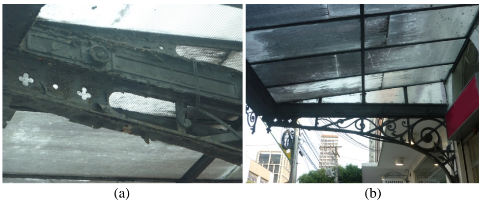
Figura 1: Estrutura metálica corroída (a) e cobertura com vidros manchados (b). Fonte: Acervo próprio.
