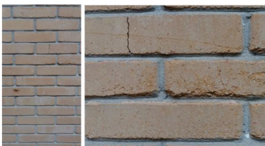
Figura 11: Fissura no bloco de solo-cimento – Predio Principal Fonte: Autor
