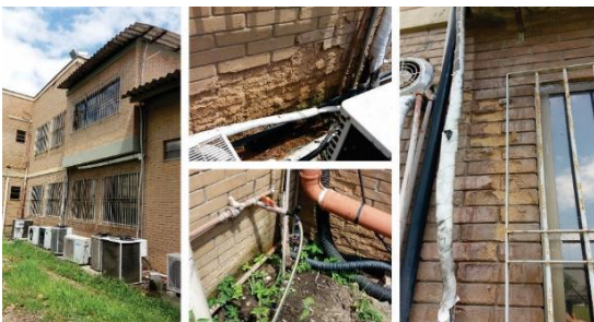
Figura 7: Parede externa com os aparelhos de ar condicionado Fonte: Autor
