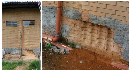
Figura 8: Parede externa ao auditório que sofreu desagregação Fonte: Autor
