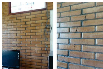
Figura 14: Fissura no bloco de solo-cimento – Módulo Fonte: Autor
