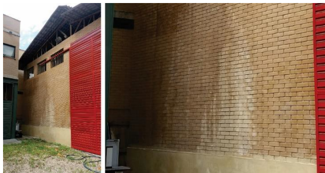
Figura 15: Eflorescência de solo-cimento – Módulo Fonte: Autor
