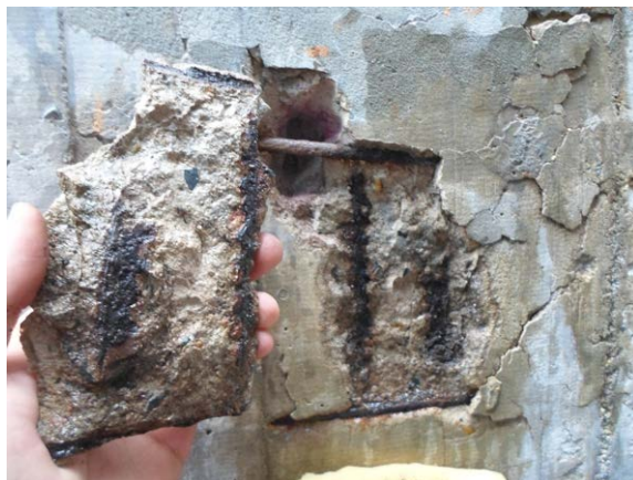
Figura 3: Deslocamento do concreto
