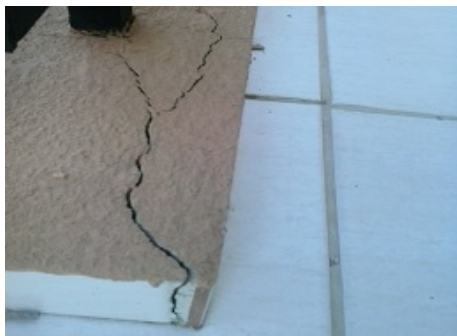
Figura 3: Fissuras em rodapé do terraço Fonte: Autor, 2017
