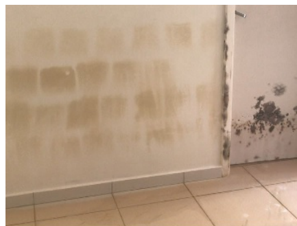
Figura 2: Paredes e portas com infiltrações Fonte: Autor, 2017
