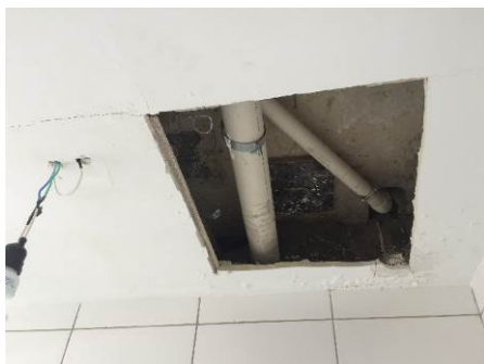
Figura 5: Tubulação de esgoto (forro) Fonte: Autor, 2017
