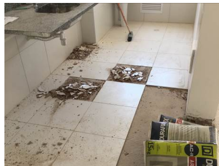
Figura 9: Pisos cerâmicos ôcos Fonte: Autor, 2017
