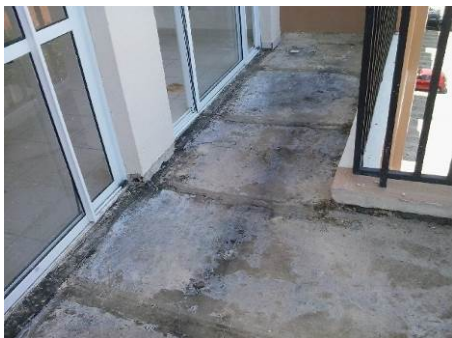
Figura 1: Manta asfáltica sem transpasse Fonte: Autor, 2017
