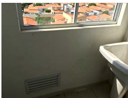
Figura 7: Falha de vedação em esquadria Fonte: Autor, 2017
