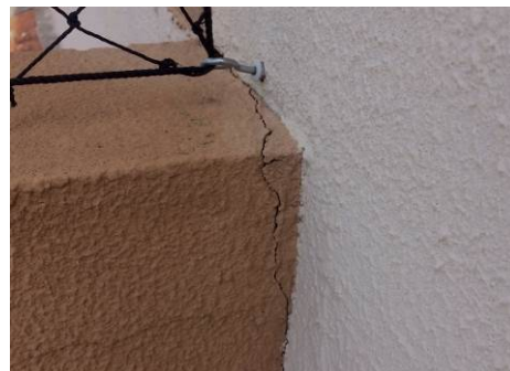
Figura 4: Fissuras em mureta do terraço Fonte: Autor, 2017
