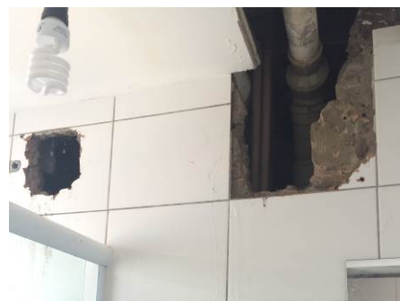
Figura 6: Tubulação de esgoto (parede) Fonte: Autor, 2017
