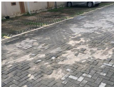
Figura 5: Falha na compactação Fonte: AUTOR, 2017
