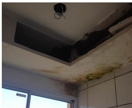
Figura 8: Infiltração para o apto abaixo Fonte: AUTOR, 2017
