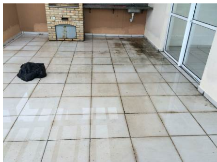
Figura 7: Falha no caimento do piso cerâmico Fonte: AUTOR, 2017
