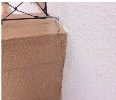
Figura 9: Trincas em mureta Fonte: AUTOR, 2017
