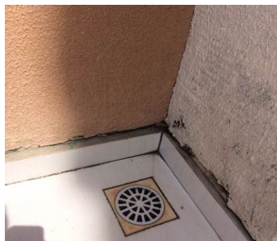
Figura 10: Deterioração da pintura Fonte: AUTOR, 2017
