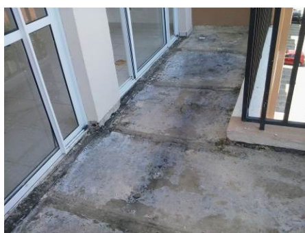
Figura 4: Falha no sistema de impermeabilização
