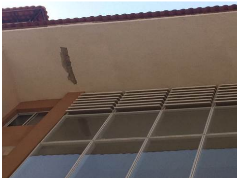
Figura 11: Deslocamento do reboco Fonte: AUTOR, 2017
