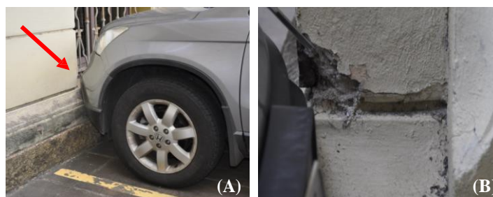
Figura 10: (A) contato direto dos veículos do estacionamento com o revestimento da fachada; (B) detalhe dos danos causados pelos impactos dos automóveis na fachada.
