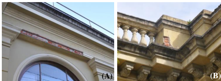
Figura 8: Deslocamento de revestimento de argamassa (A) no entablamento da fachada interna voltada ao pátio; (B) na platibanda da fachada noroeste [Fonte: Antunes et al. , (3)].
