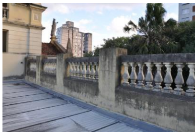
Figura 5: Platibanda balaustrada com manchas escuras sem capeamento [Fonte: Antunes et al. , (3)].
