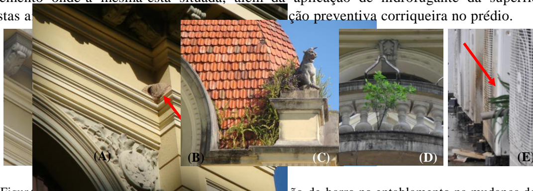
Figura 9: (A) e (B) presença de ninho de pássaro no entablamento na mudança de plano entre as fachadas SE com NE e no entablamento da fachada sudoeste respectivamente; (C) (D) (E) presença de vegetação na fachada NO, SO e NE, respectivamente.
