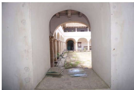
Figura 5: Materiais (vidros) abandonados na entrada do claustro.
