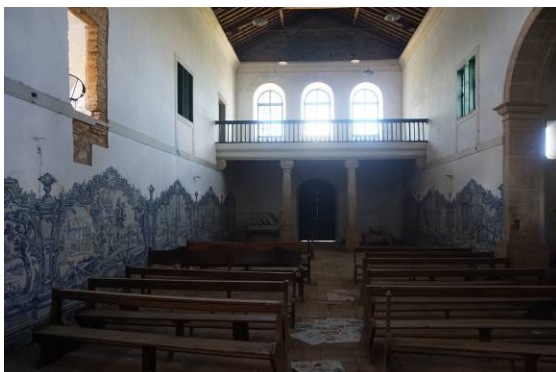
Figura 15: Vista do coro da igreja. Janela sem vedação.
