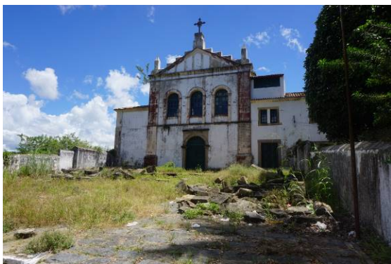
Figura 2: Fachada principal e adro, com mato e pedras que formavam a calçada, impedindo o acesso à igreja.
