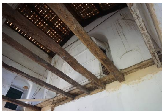
Figura 14: Forro e piso para o acesso à parte superior do altar, completamente destruídos.
