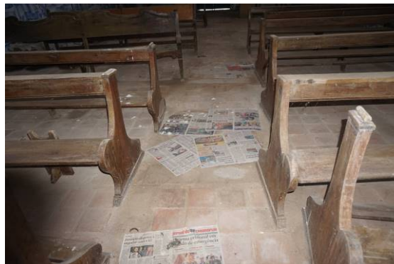
Figura 16: Bancos danificados. Restos e sujeiras de obras sobre o piso, cooperando para danificá-lo ainda mais.
