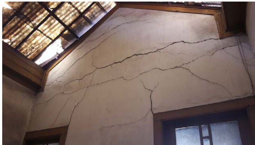
Figura 10: Fissuras no reboco de uma parede
