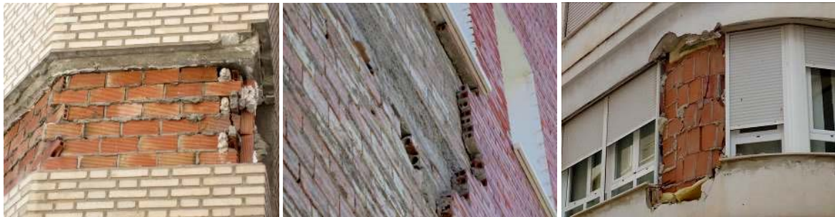
Figura 2: Daños provocados por la ausencia de apoyo sobre el forjado de paño exterior de cerramiento
