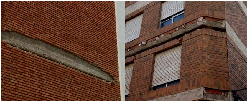
Figura 5: Caída de las franjas de discontinuidad en los paños de cerramiento del recubrimiento del testero de la estructura horizontal
