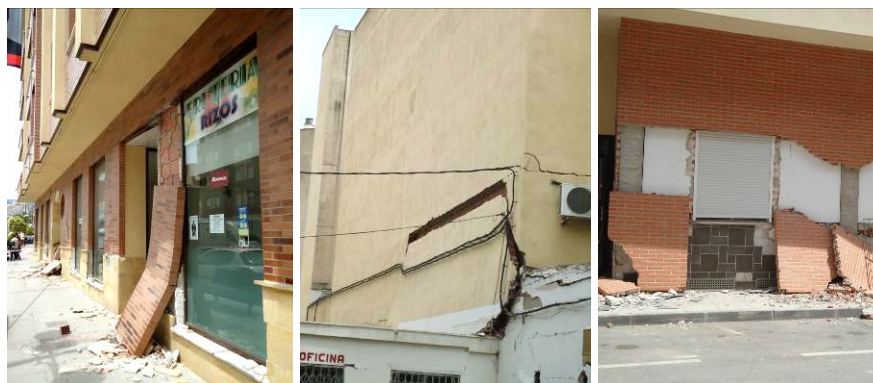
Figura 6: Caída de los paños en plantas inferiores debido a una inadecuada sujeción y/o apoyo de los mismos.
