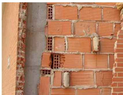
Figura 3: Solución de fijación de la hoja exterior mediante la colocación a tizón de ladrillos del paño interior tomado con mortero
