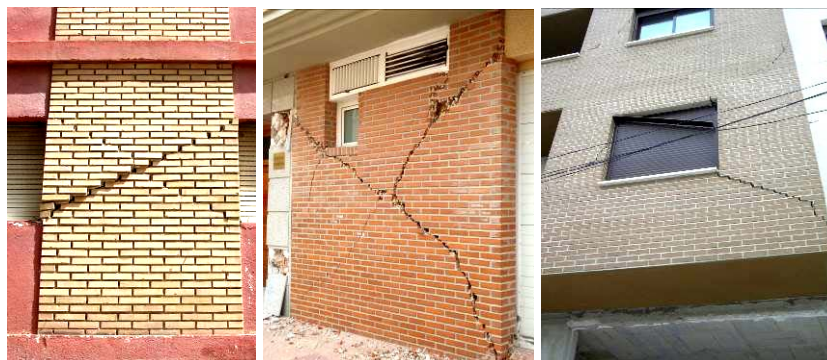
Figura 8: Roturas en aspa en cerramientos.
