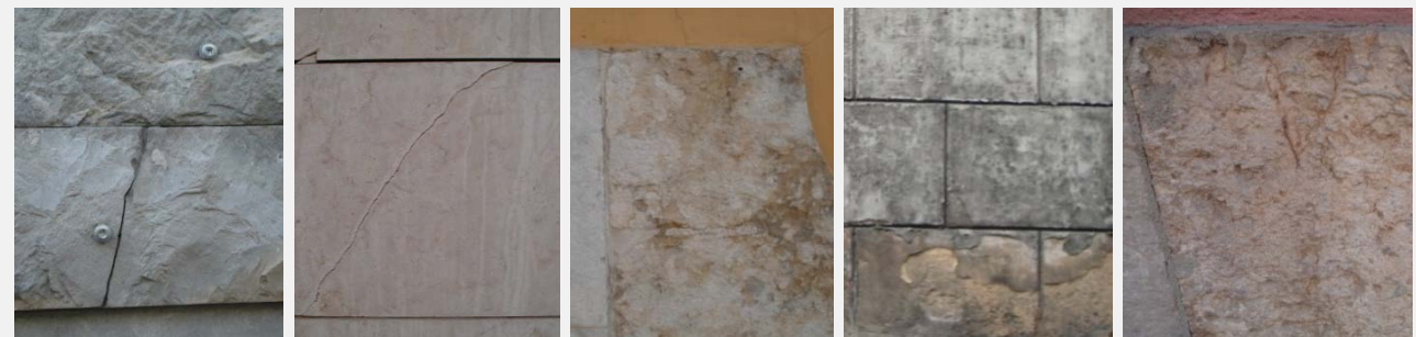
Anomalias de perda de integridade
