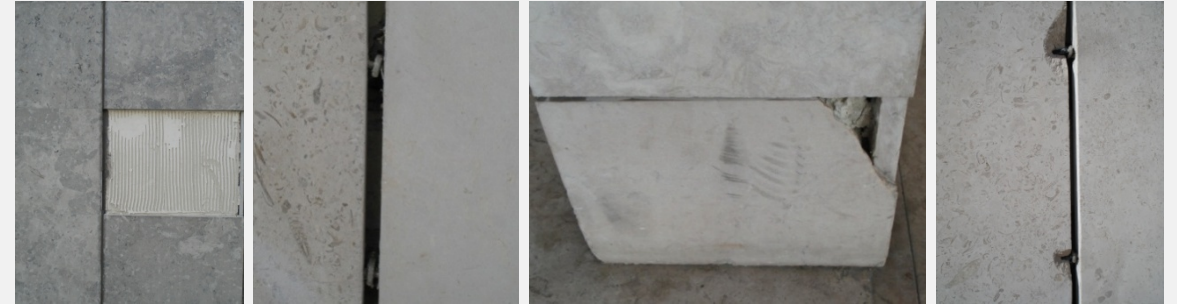
Anomalias na fixação ao suporte
