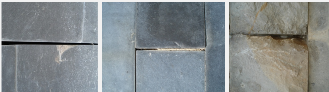
Anomalias em juntas
