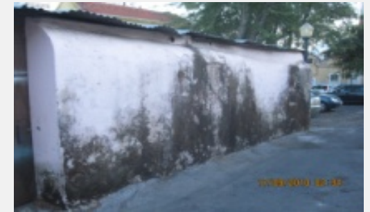
Alterações muito acentuadas e degradação elevada
