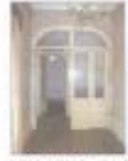
F.11 Possibilita a visualização do arco do vão em madeira no compartimento C2.05.
