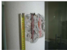
F.3 Sondagem S_49 no compartimento C-1.01 possibilita a visualização do pilar com um perfil HEB 180 revestido a argamassa de cimento.
