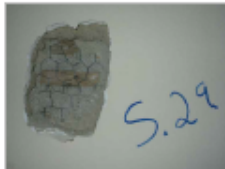
F.1 Sondagem S_29 no compartimento C-1.07 possibilita a visualização da parede em tabique duplo com rede galinheiro e argamassa de cimento.
