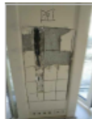
F.6 Sondagem S_53 no compartimento C-1.01 possibilita a visualização da parede de alvenaria de calcário e tubagens eléctricas embudadas na argamassa de cimento.
