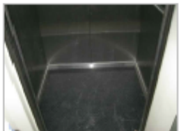
F.9 - Caixa do elevador chapa de aço inox e piso com forra de borracha
