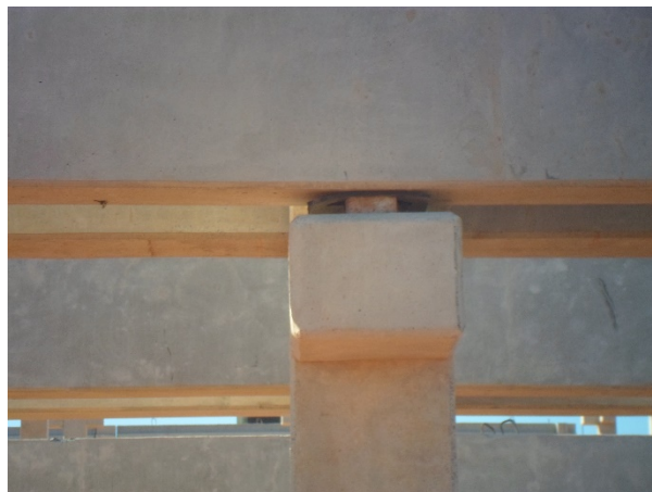
Figura 6: Calço de madeira em estrutura de console de pilar (Fonte: Próprio Autor)
